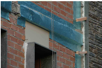
Rotura de puente térmico
